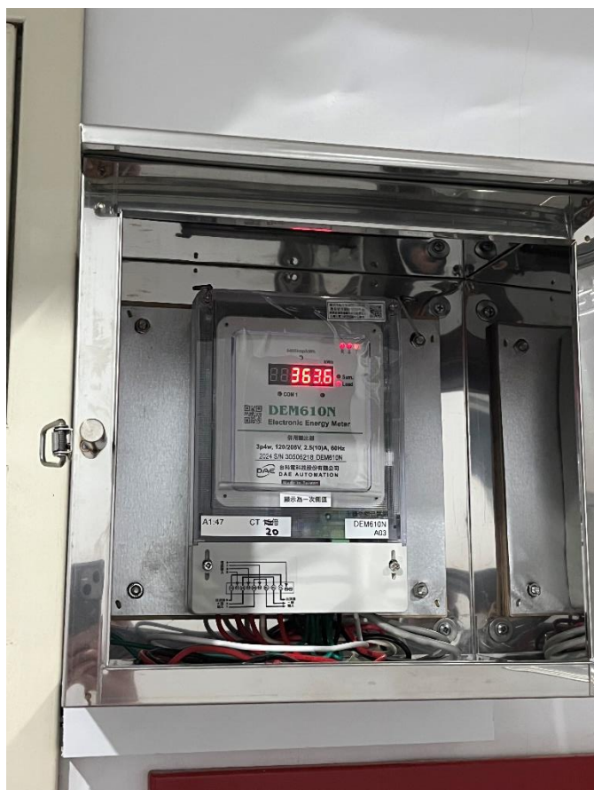
各樓層加裝110V數位電表監控用電
